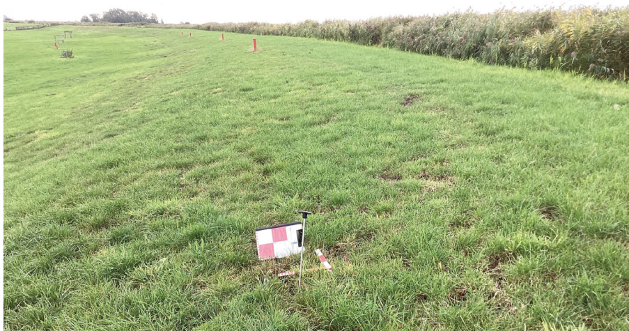
▲ Scheurvorming bij de Belmermeer in de kruin van de kering. Op de achtergrond zijn peilbuizen ten behoeve van grondwatermonitoring te zien. (Foto: HHNK)
